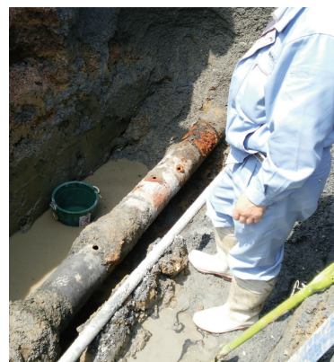
↑老朽化が進み、漏水した水道管。状況に応じて更新を行っています。
